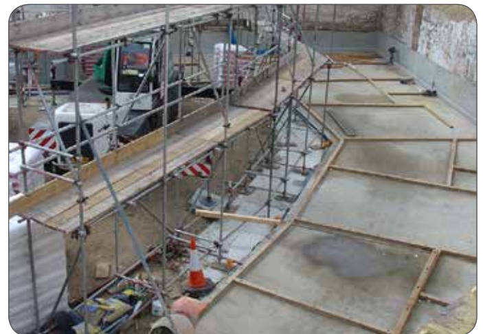
Bevor es mit der Montage losging, wurden Richthölzer auf die Bodenplatte verlegt.
